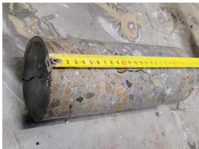
Fot. 13. Próbką rdzeniową pobraną z zarysowanego miejsca
