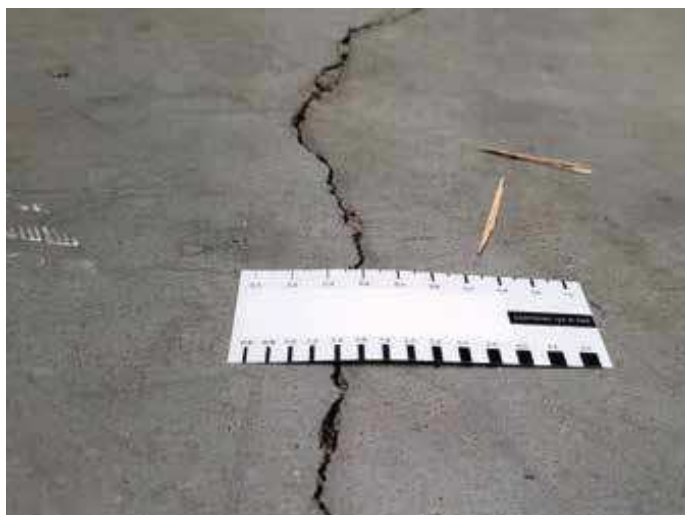
Fot. 8. Wykruszanie krawędzi rys
