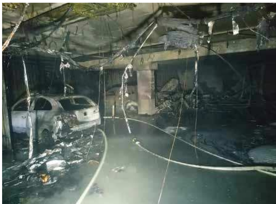
Fot. 2. W wyniku pożaru częściowemu uszkodzeniu uległa konstrukcja budynku, instalacje oraz pojazdy znajdujące się w garażu podziemnym [16]
