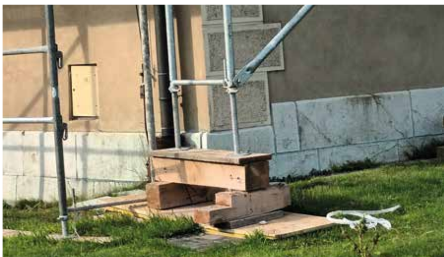
Fot. 3. Przykład nieprawidłowego posadowienia rusztowania
